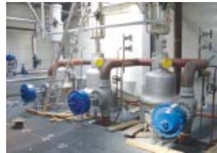
Anfahr- und Bypass-Station
