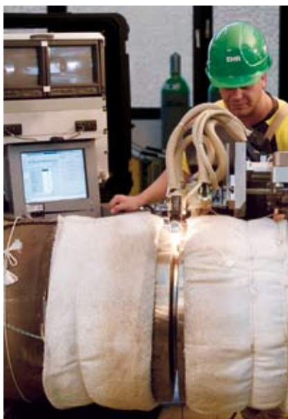
Abnahme der neuen Orbitalanlage, Schweißen eines dickwandigen Rohres im neuen Orbitalcenter im Werk Dortmund
