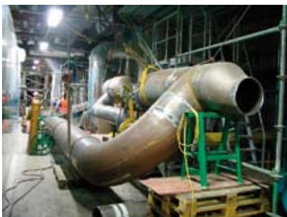
Vorgefertigte Dampfleitung DN 600
